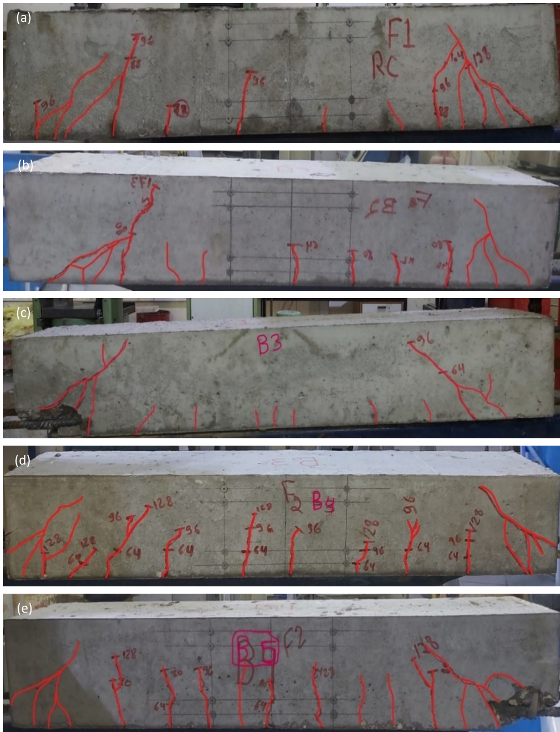
Figure 10. Crack Propagation for Beams (a) B1, (b) B2, (c) B3, (d) B4, and (e) B5.
